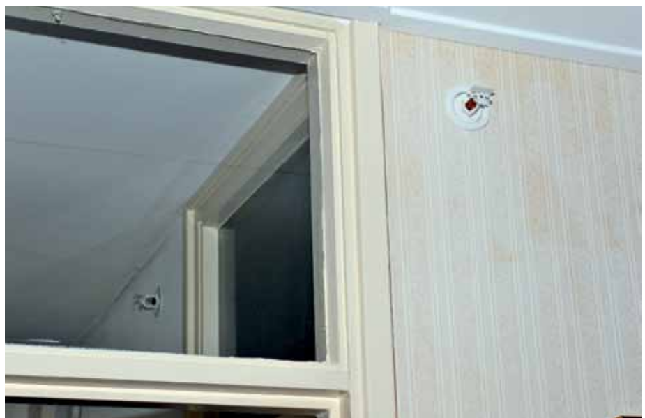
Wandsprinklers in huiskamer bewoners.
