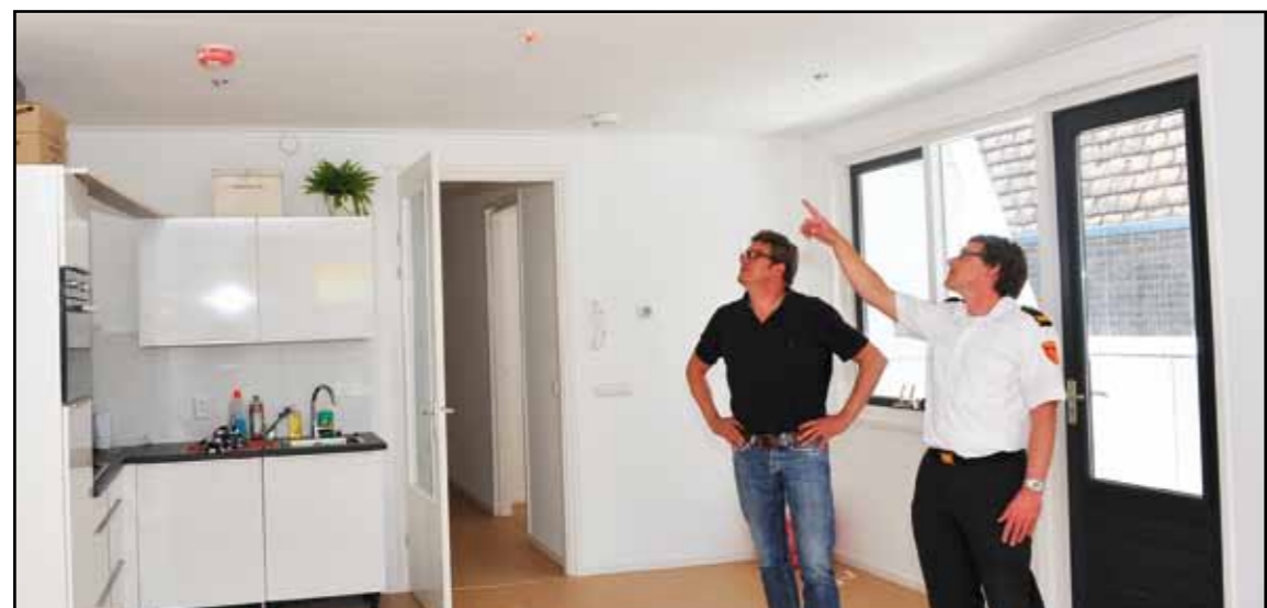
Aannemer Henk Jellema en brandweerspecialist Eise Dijkstra bekijken de geïnstalleerde woningsprinkler.
