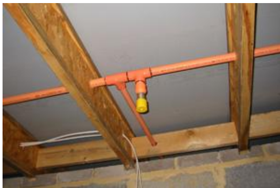
In de Verenigde Staten kost een woningsprinkler op dit ogenblik nog maar 3,50 euro per m 2 te sprinkleren oppervlak.
